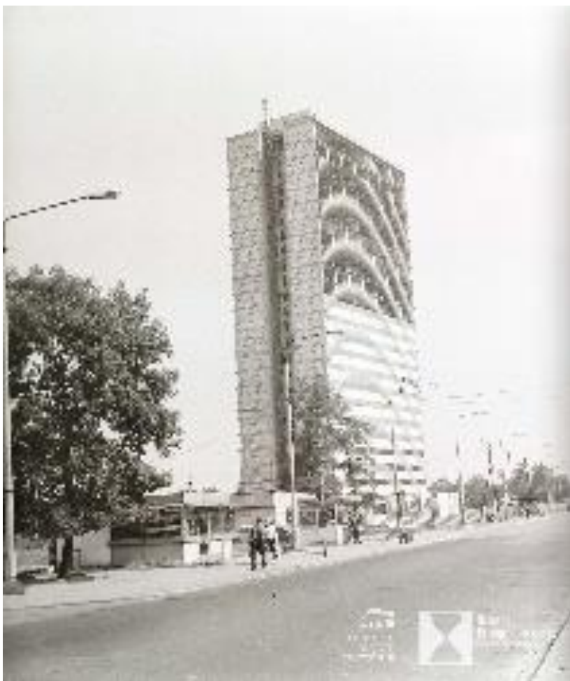
Budowa gmachu „Poltegoru” we Wrocławiu (ówcześnie nazywany był „żyletkowcem”). Wrzesień 1978 roku, Zbigniew Nowak; OPIP
